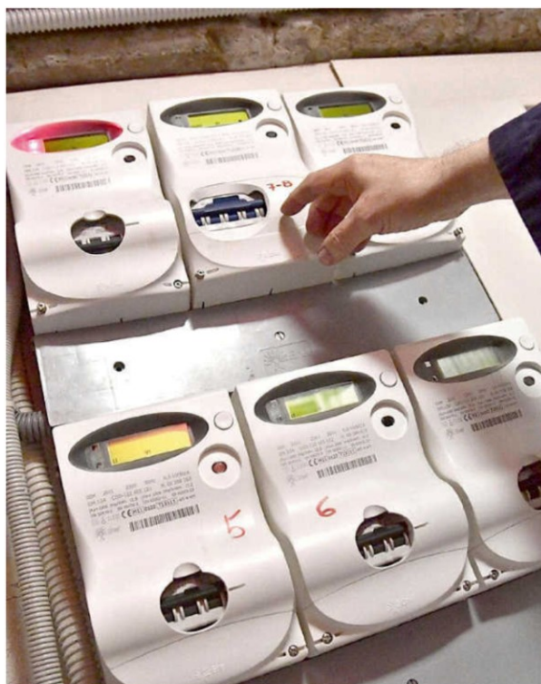
➊ Contatori di energia elettrica
