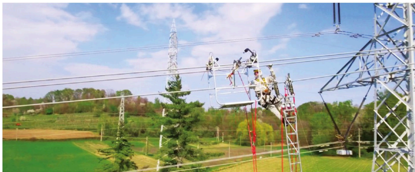
Rete elettrica. Un tecnico Terna al lavoro su uno degli elettrodotti del gruppo
