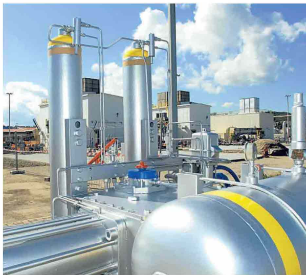
▲ Un impianto di Snam
