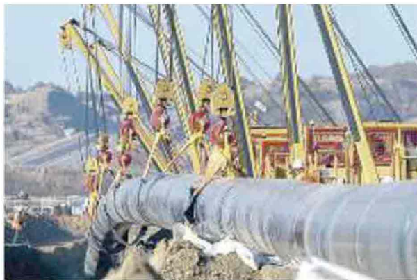
Il gasdotto Tap che dalla Grecia porta il metano in Puglia
